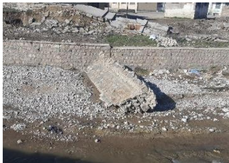
تخریب دیواره در سیل آبان ۱۴۰۲
